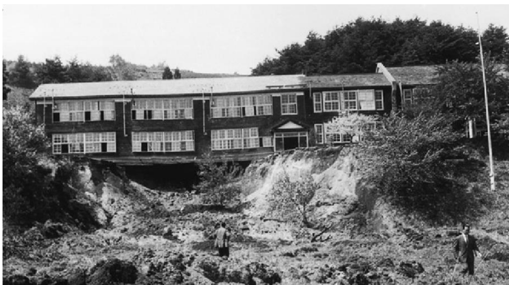
図9 十勝沖地震（1968）による青森県剣吉中学校校庭での土砂崩れ
